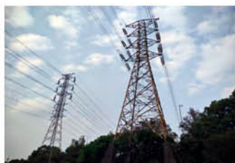
高壓電塔及傳輸線
