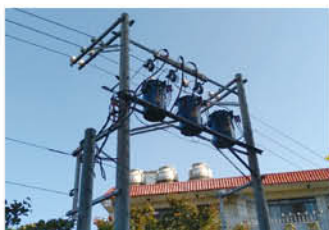
電線桿上的變壓器
