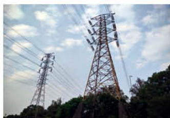
高壓電塔及傳輸線
