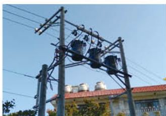
■ 電線桿上的變壓器
