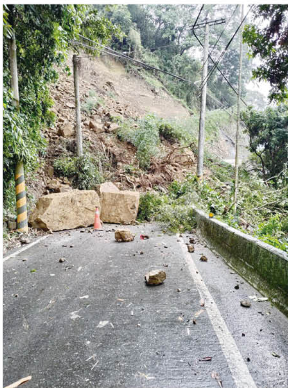
大華公路落石坍方勘查
