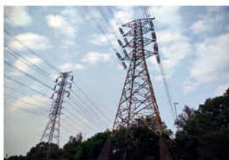
■ 高壓電塔及傳輸線
