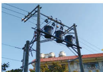
■ 電線桿上的變壓器
