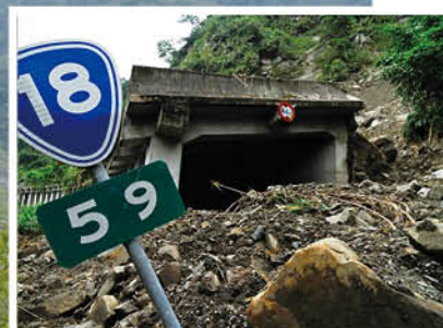
■ 風災後的台 18 線隧道
