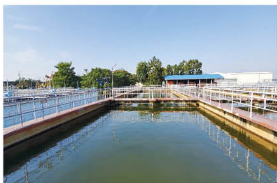
■ 淨水場內的水池
