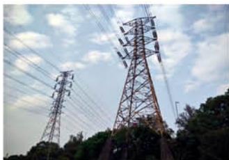
高壓電塔及傳輸線
