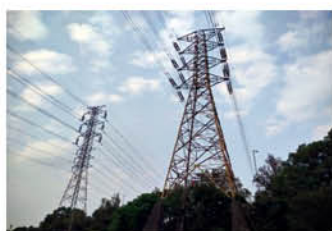
■ 高壓電塔及傳輸線
