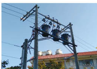
■ 電線桿上的變壓器
