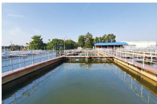
淨水場內的水池
