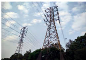
高壓電塔及傳輸線
