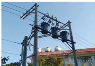
電線桿上的變壓器
