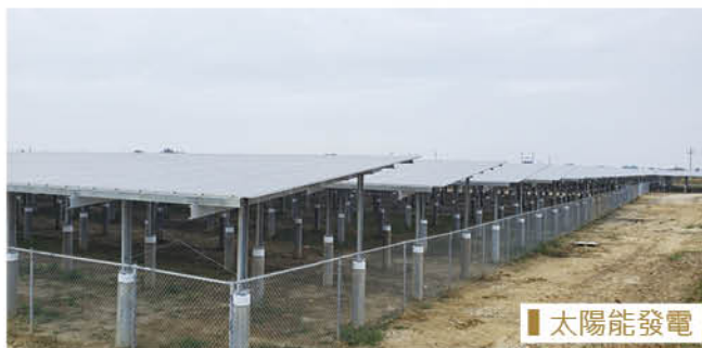
浮動式太陽能配電室
