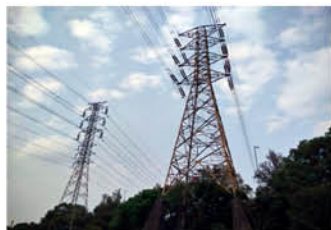
高壓電塔及傳輸線
