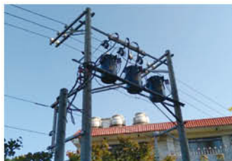
電線桿上的變壓器
