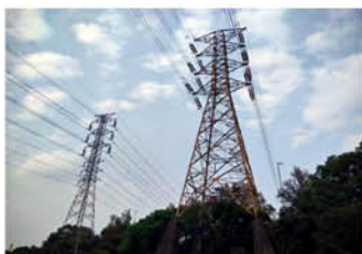
■ 高壓電塔及傳輸線
