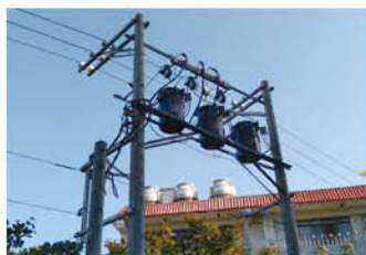
■ 電線桿上的變壓器
